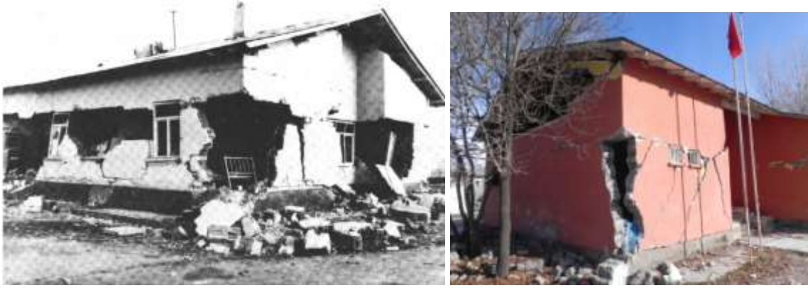
Resim 35. Soldaki resim 1976 Muradiye-Çaldıran (Van) Depremi'nde hasar gören Çaldıran Sağlık Ocağı fotoğrafı. Sağdaki resim ise 2011 Tabanlı-Van Depremi'nde hasar görmüş Gedikbulak Sağlık Ocağı. Muradiye-Çaldıran Depremi fotoğrafı Gülkan (ve diğerleri, 1978; s.55) den alınmıştır.
