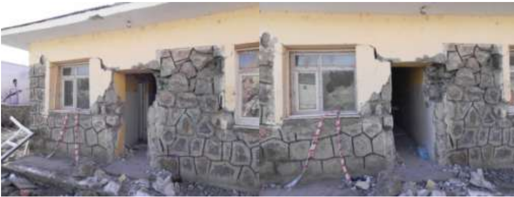
Resim 30. Kırsal alan konutlarında (yığma yapılarda) görülen tipik hasarlar.
