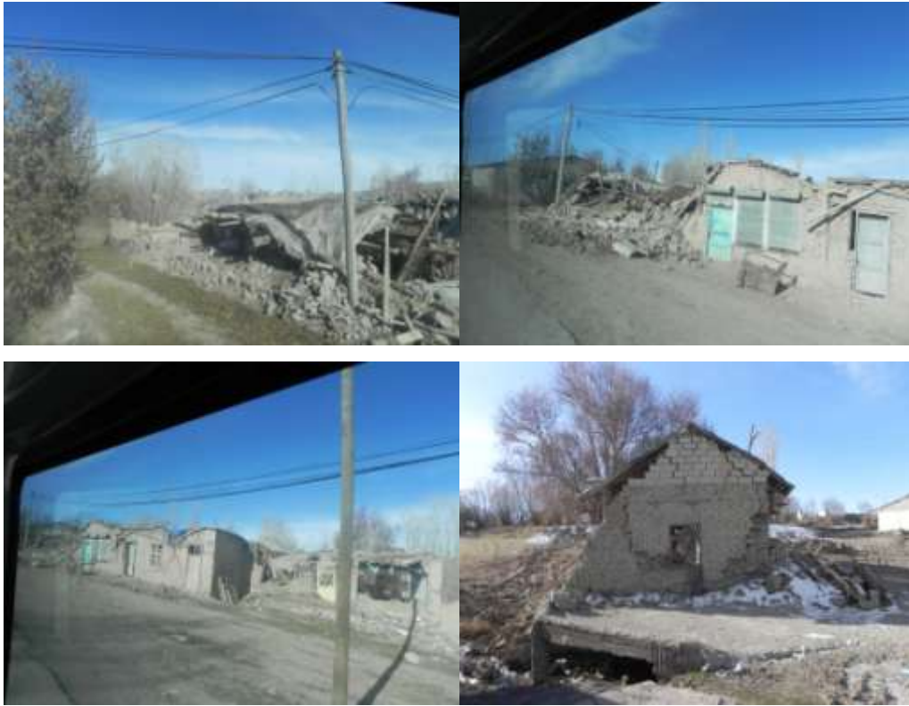
Resim 28. Kırsal alan konutlarında (yığma yapılarda) görülen tipik hasarlar.
