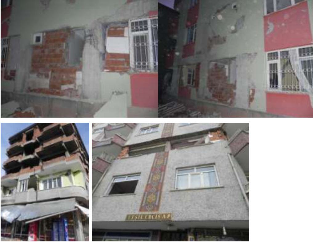
Resim 23. Tipik dolgu duvar hasarları.
