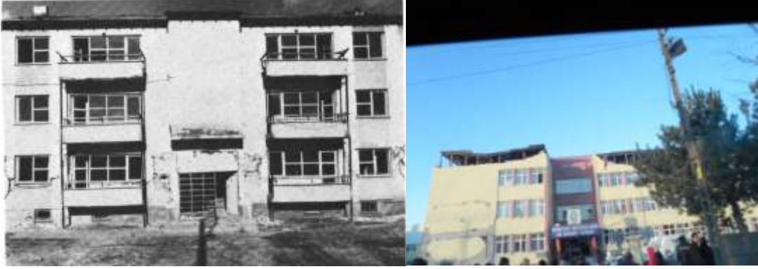
Resim 36. Soldaki resim 1976 Muradiye-Çaldıran (Van) Depremi’nde hasar gören kamuya ait bir bina. Sağdaki resim ise 2011 Tabanlı-Van Depremi’nde hasar görmüş kamuya ait başka bir bina. Muradiye-Çaldıran Depremi fotoğrafı Gülkan (ve diğerleri, 1978; s.56) den alınmıştır.
