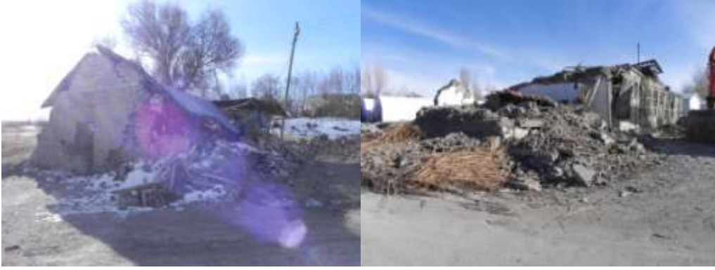
Resim 29. Kırsal alan konutlarında (yığma yapılarda) görülen tipik hasarlar.
