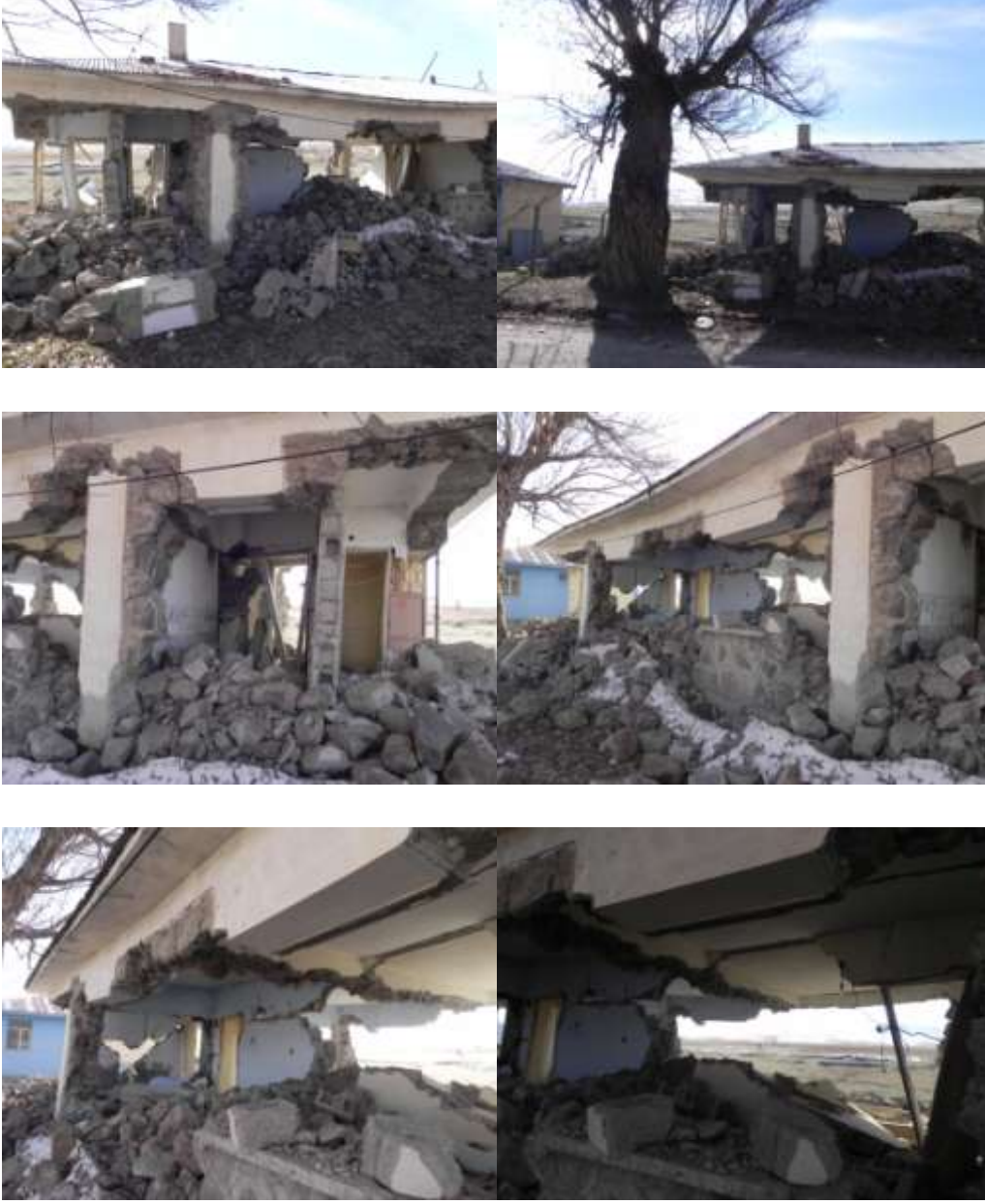
Resim 31. Kırsal alan konutlarında (yığma yapılarda) görülen tipik hasarlar.
