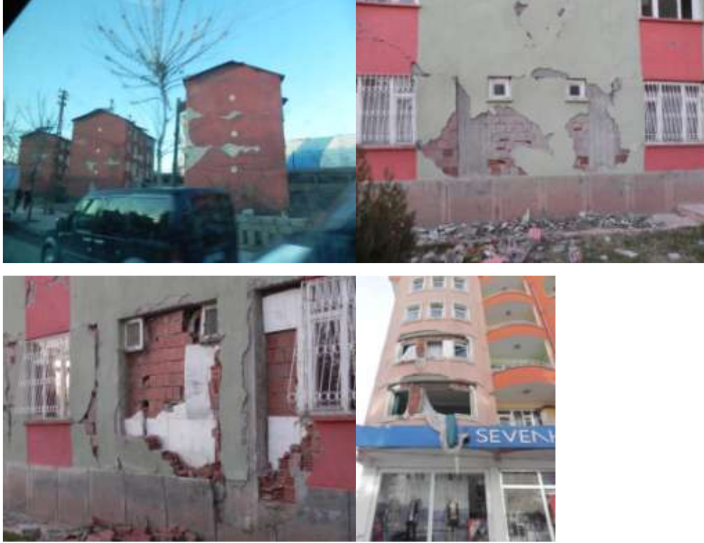
Resim 20. Bina dış yüzeylerinde ve dolgu duvarlarda görülen tipik hasarlar.
