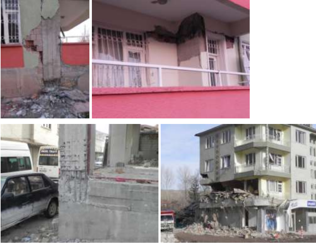
Resim 22. Kolon uç bölgelerinde plastik mafsall oluşumu.
