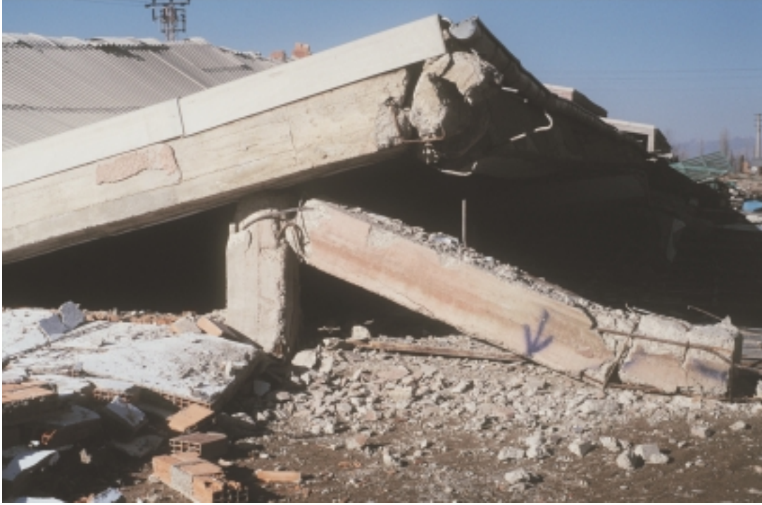
Şekil 9. Çay Sanayi Sitesindeki, tümüyle yıkılmış tek katlı betonarme yapılardan birisinin yakın görünümü.
