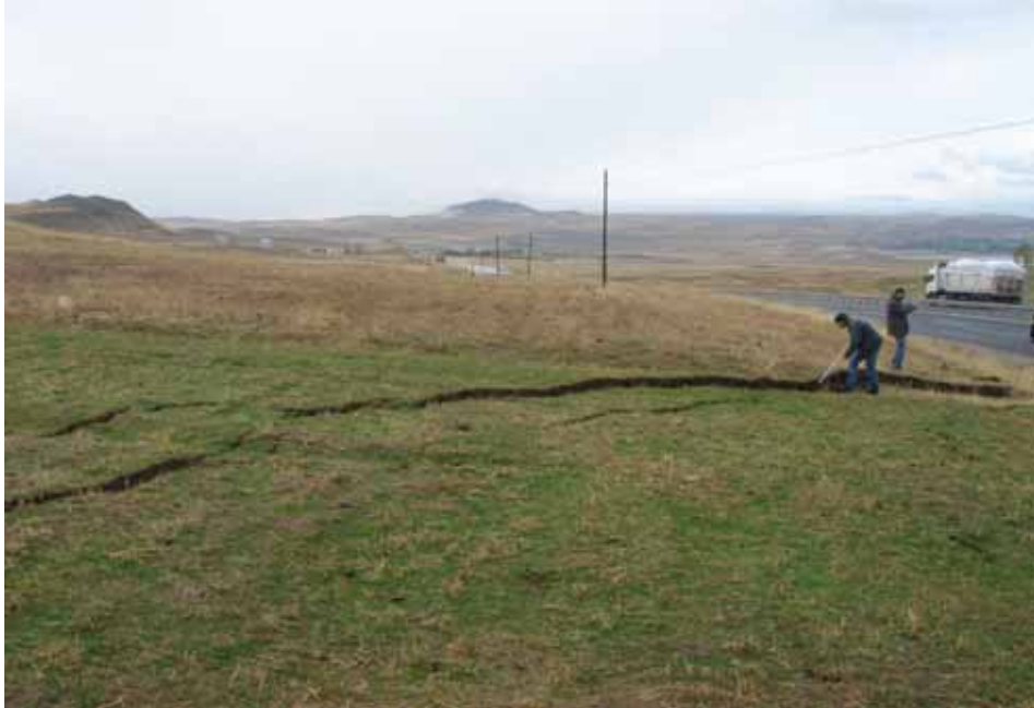
Şekil 2.8. Van-Erciș Karayolu şev kayması dikey deformasyon.
