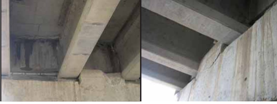
Şekil 4.2. Hasar görmüş deprem takozları.
