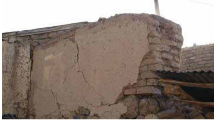
Şekil 3.25. Çamur harç ile örülmüş kerpiç yığma duvarda deprem sonrası ortaya çıkmış olan hasar.
