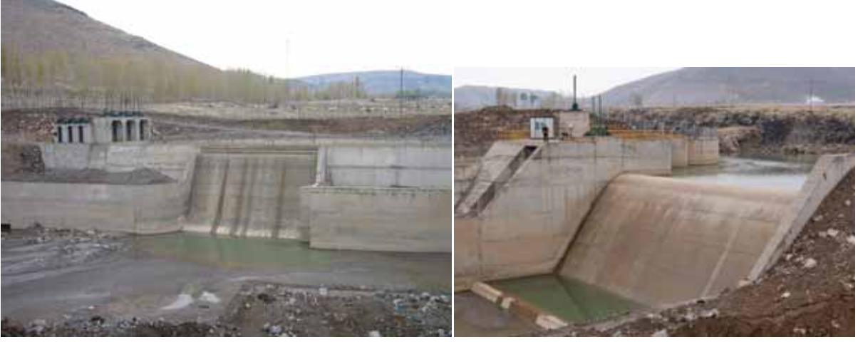
Şekil 4.8. Muradiye ilçesi yakınlarında bulunan barajın deprem sonrası genel görüntüleri.
