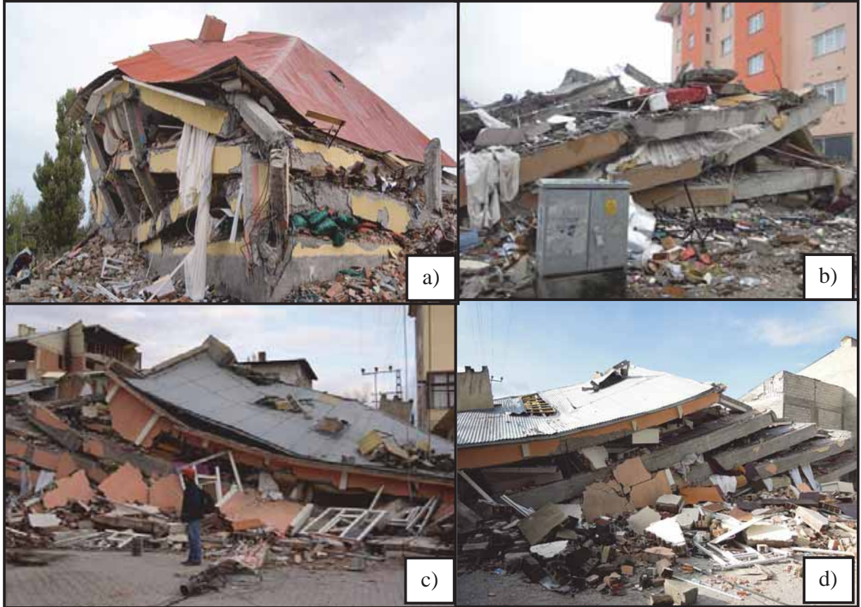
Şekil 3.2. Katların üst üste yığılması sonucu yıkılan binalar.
