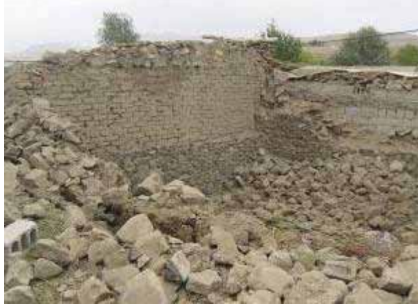
Şekil 3.27. Taşıyıcı duvarlarında farklı malzemeler (kerpiç, taş, briket) kullanılmış ve Van depremi esnasında yıkılmış bir yığma bina.
