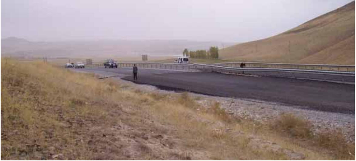
Şekil 2.10. Van-Erciş yolu üzerinde Gedikbulak Köyü yakında karayolu hasarı ve onarımı.
