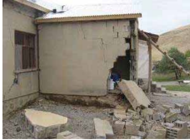
Şekil 3.24. Bims yapı malzemesinden yapılmış bir kırsal yığma binada gözlenen hasar.
