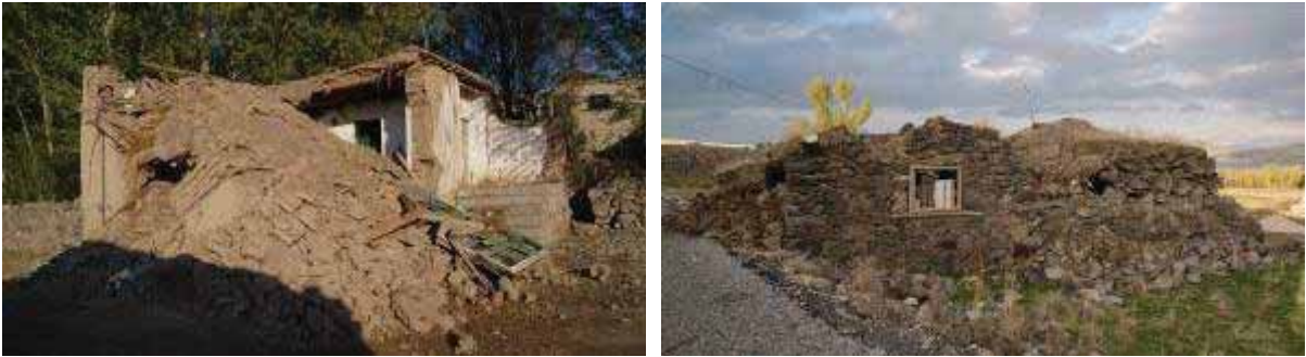
Şekil 3.23. Dayanımı yetersiz yığma malzemesi kullanımı sonucu ortaya çıkan hasar; sol panel: kerpiç yığma yapı, sağ panel: moloz taş yığma yapı.
