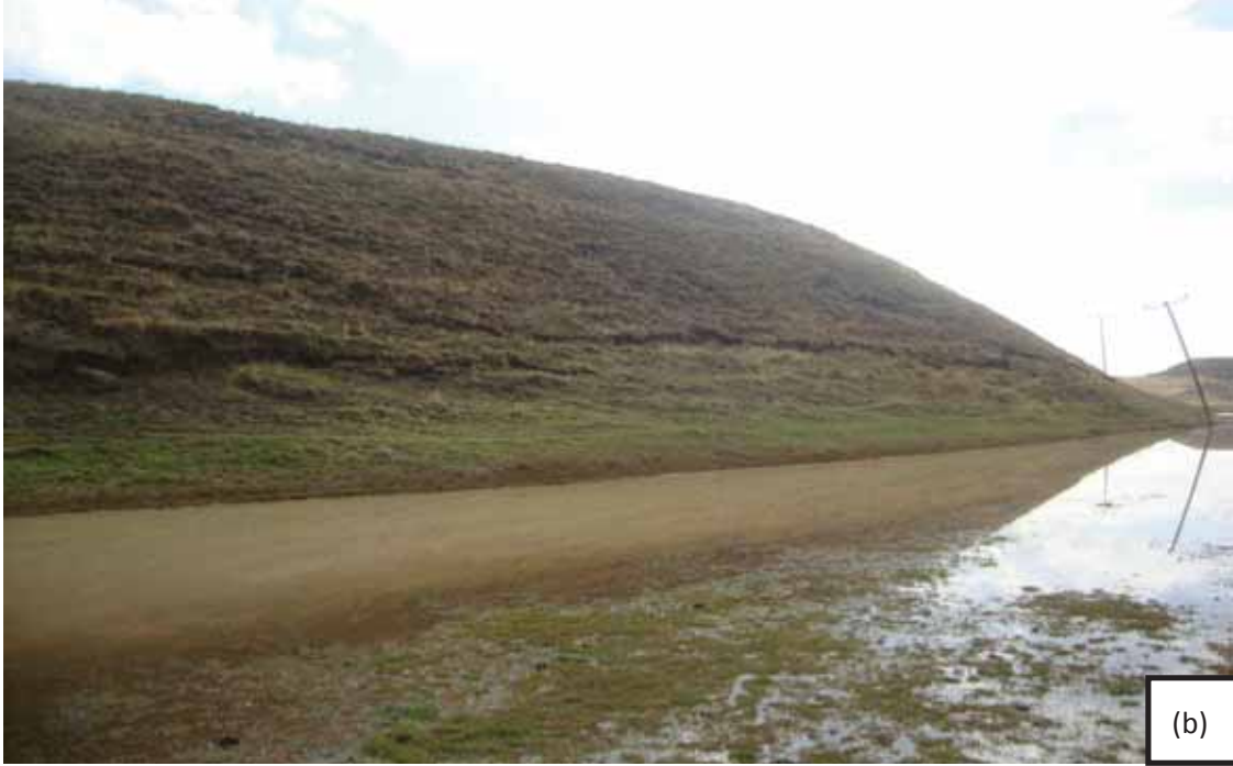
Şekil 2.6. Topaktaş köyü arazisinde Karasu kıyısında yer alan doğal bir şev ve şev stabilitesi problemi.
