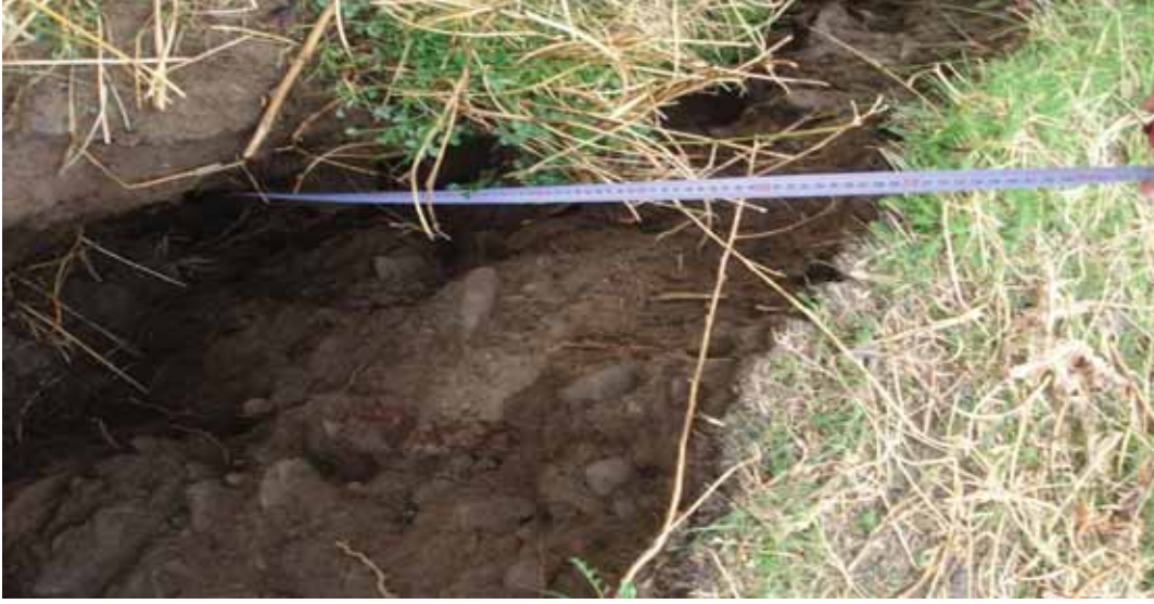
Şekil 2.11. Van-Erciş Karayolu şev kayması çatlakları.
