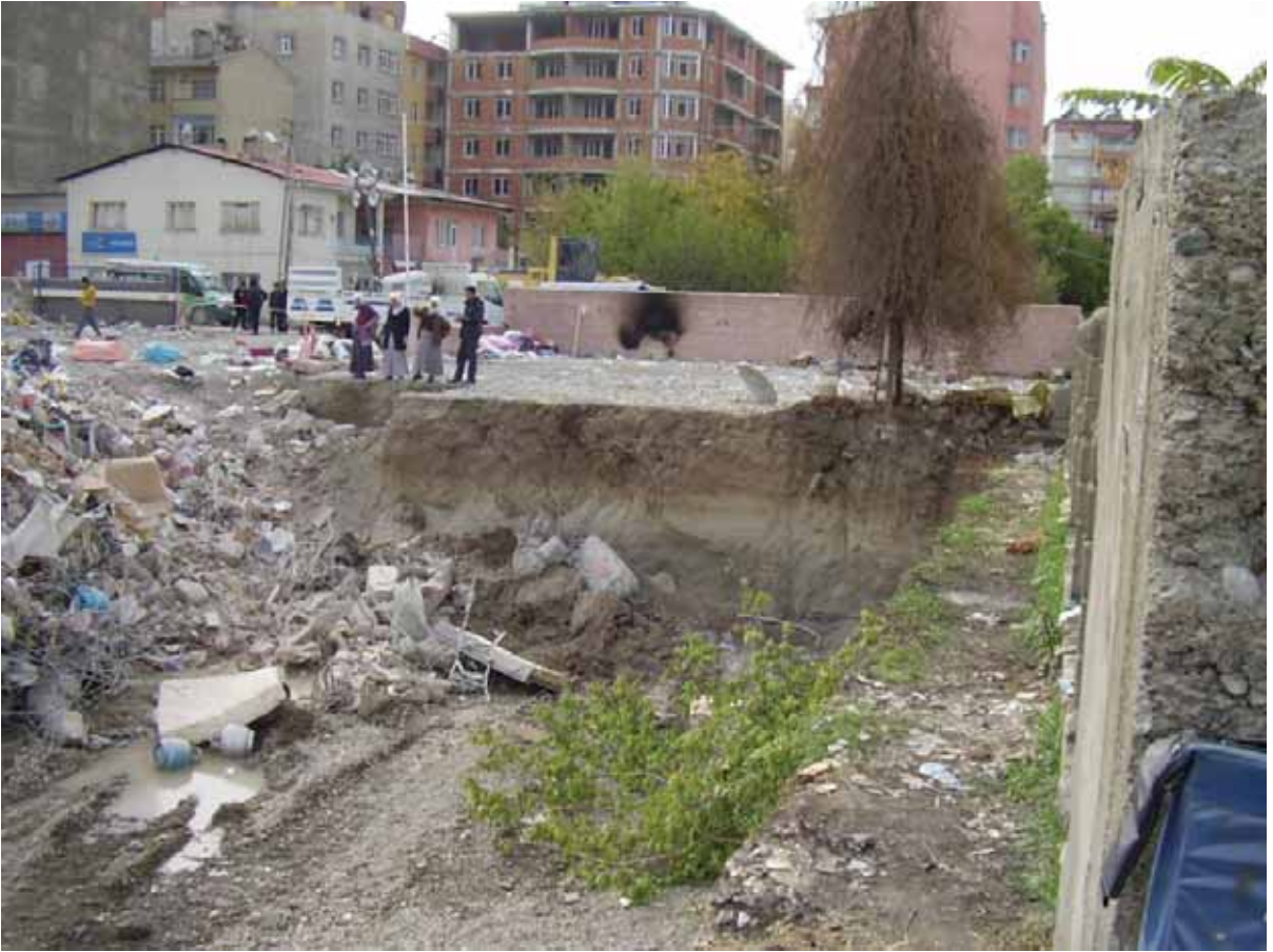
Şekil 2.3. Bahçıvan Mahallesi’nde göçen 2 betonarme binanın arkasındaki dik kazı.
