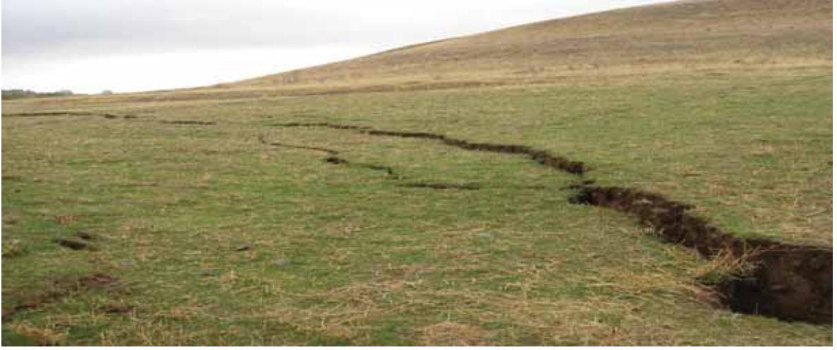
Şekil 2.9. Van-Erciş Karayolu şev kayması taç bölgesindeki çatlaklar.
