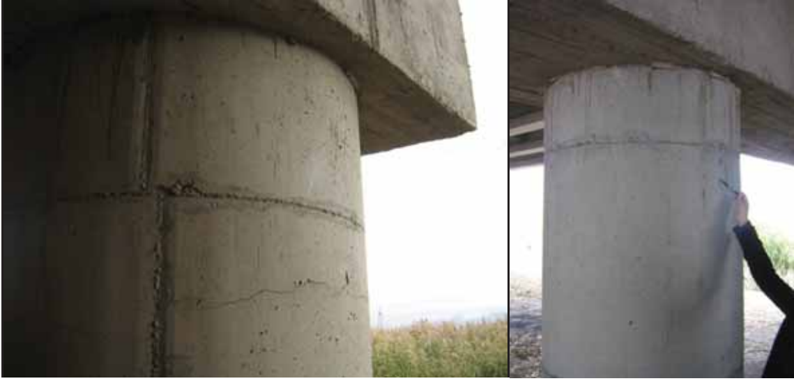
Şekil 4.3. Deprem sonrası çatlamış köprü kolonları.
