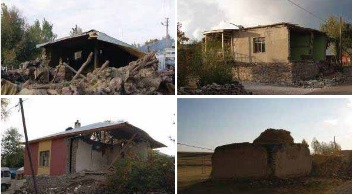
Şekil 3.26. Duvar-duvar, duvar-döşeme bağlantılarındaki zayıflıklardan dolayı düzlem-dışı hasara zorlanmış olan yığma yapılar.
