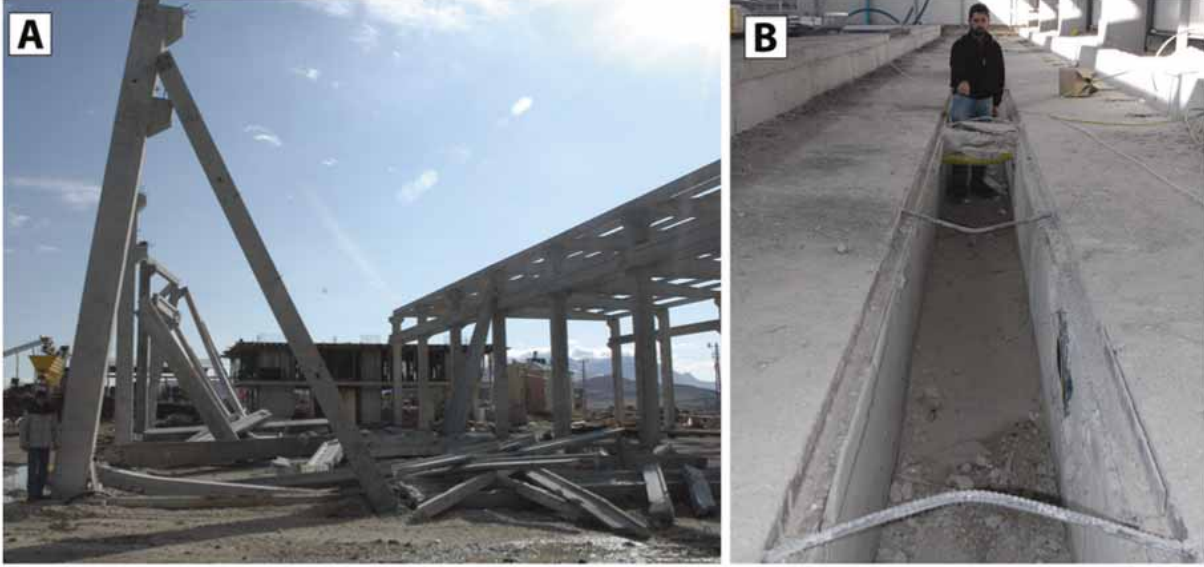
Şekil 1.7. (a) K-G sıkışmayı gösteren güneye yıkılmış kolonlar, (b) Organize sanayi bölgesinde demir çubuklarda gözlenen K-G yönlü sıkışma yapıları.
